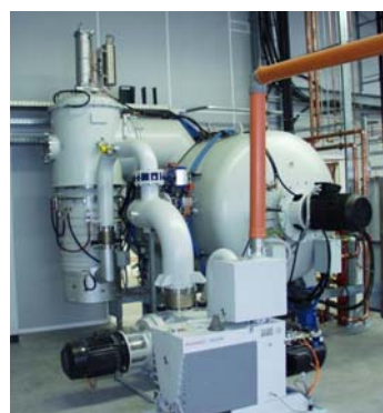
Bild 6: COV 823 HV – Pumpstand
